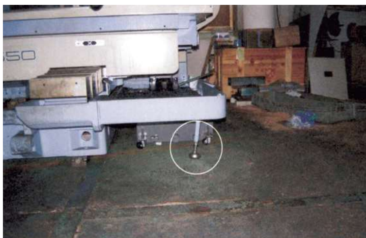
写真1-13 フライス盤の脚部の損傷（兵庫県南部地震）
