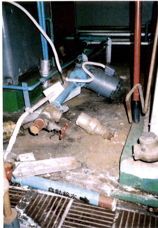
写真 2-4 破損したボイラー給 水装置
