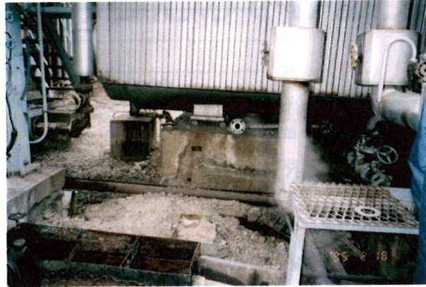
写真 2-2 プロセス用水管ボイラー まわりの地盤沈下
