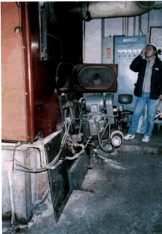
写真 2-3 鋳鉄製ボイラー前面 のロータリバーナ破損
